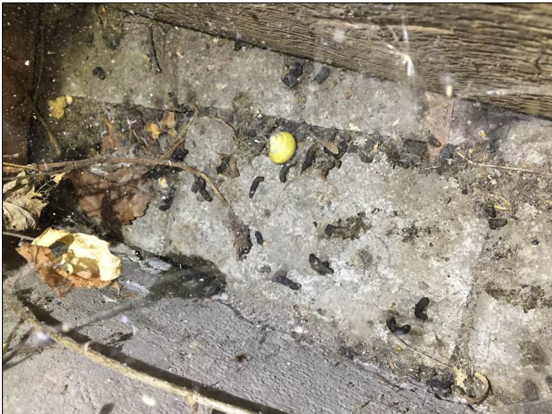
Abb. 9: Garagen (Gebäude B) mit Fledermauskot im Inneren.
