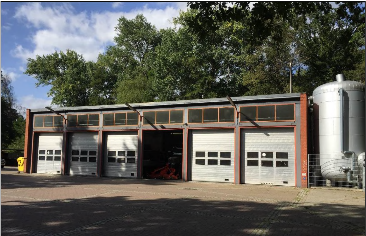
Abb. 11: Ehemalige Feuerwehr (Gebäude E) mit Fledermauskot im Inneren.
